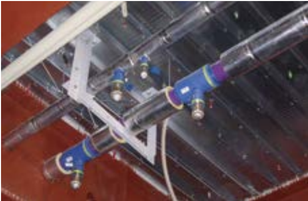
天井内配管（ネジで分岐）
